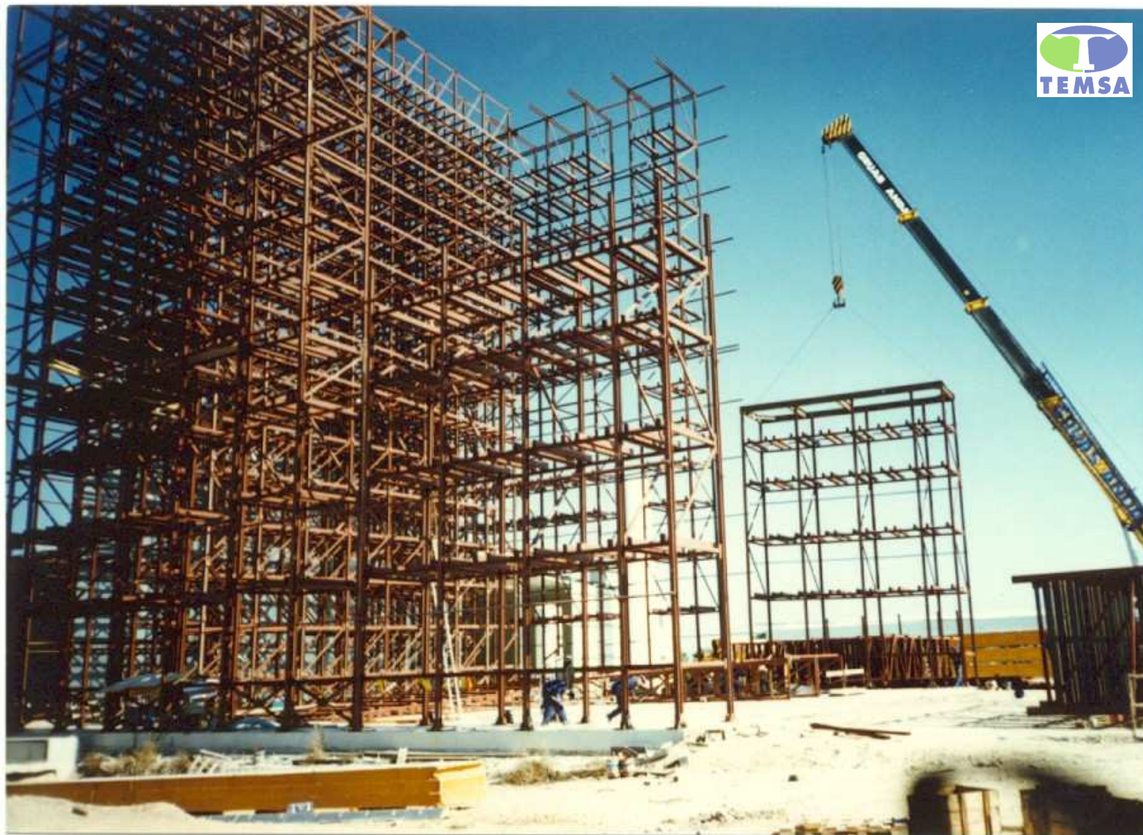
Cámara frigorífica 30x30x30 Bigastro (Alicante)
