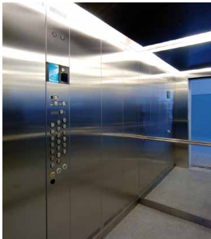
La cabina se realizó íntegramente en Enor reflejando la idea original del arquitecto con todos sus detalles.
