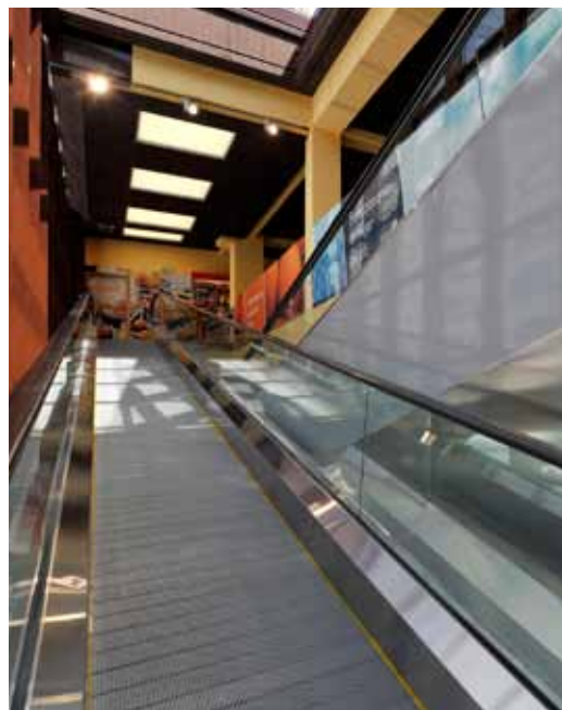
Rampa mecánica para el supermercado Gadis en A Coruña, un ejemplo de soluciones orientadas a superficies comerciales.
