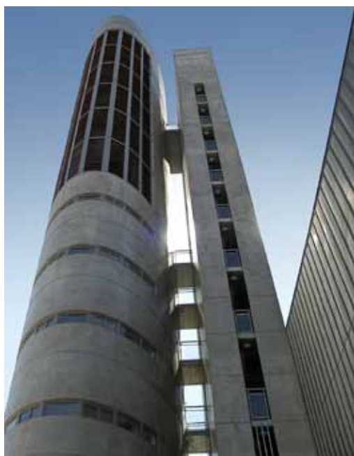
Elevador instalado en Carrilón Alverca, Lisboa, Portugal.
