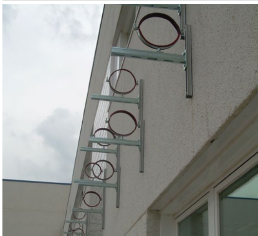
Colectores aéreos en muro de ladrillo.
