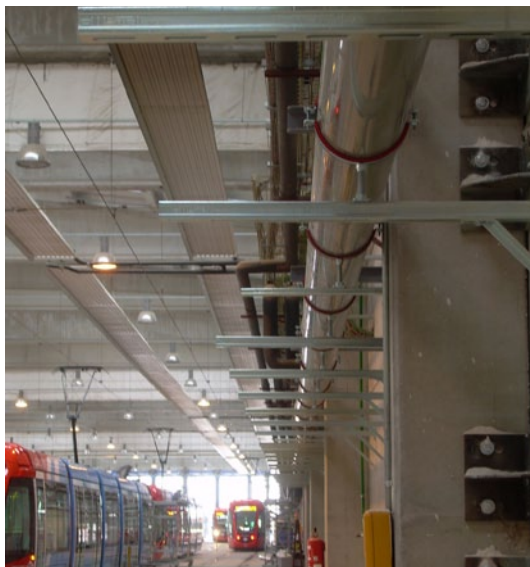
Colectores aéreos en nave de estacionamiento.
