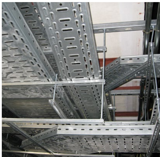
Instalaciones complejas y densas.
