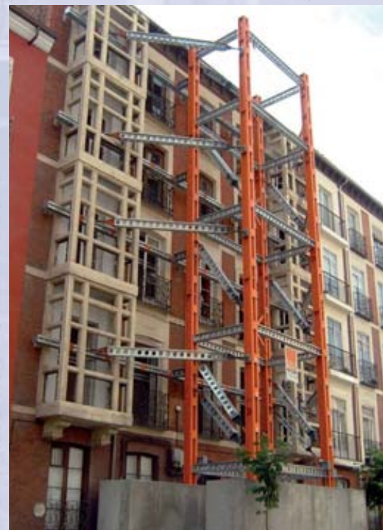
Cliente: Beleyma Proyecto: Estabilizador de fachada, C/ Gamazo, Valladolid
