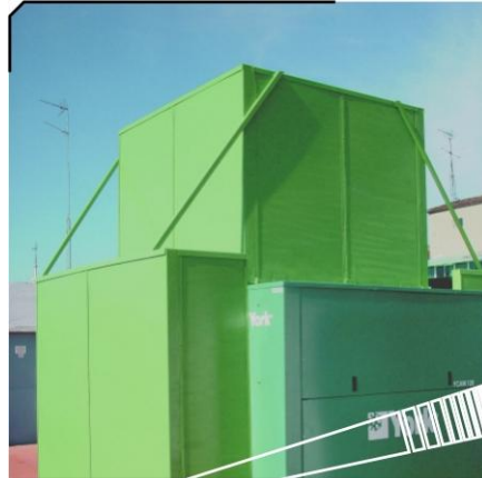
Atenuación de ruido de máquinas climatizadoras de gran tamaño
