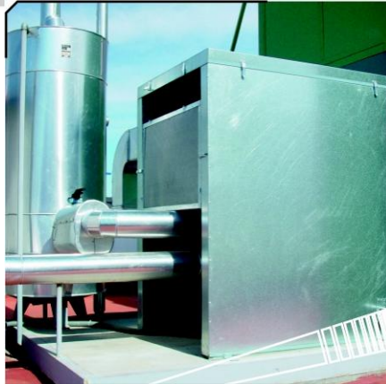
Destinado a una bomba de agua de climatización
