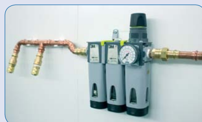
Equipo montado en pared
