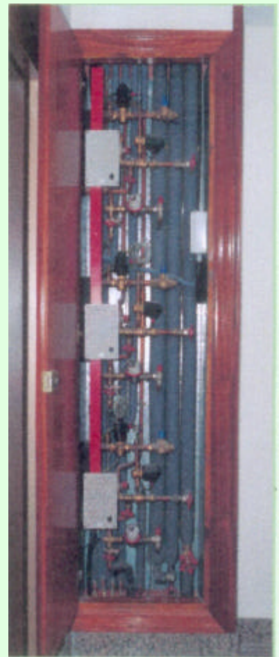
Fig 2. Caja de tres subcentrales .
