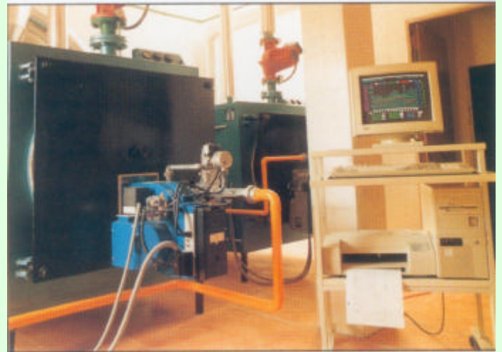
Fig 2. Cuarto de calderas
