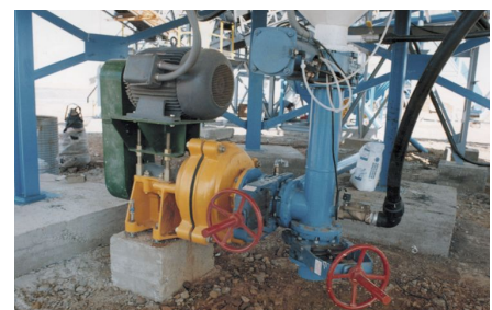
Sistema de descarg a lodos bajo tanque
