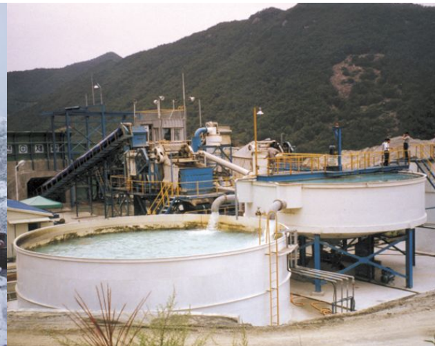
Clarificador 12 m Ø y agua clarificada en lavado de arenas
