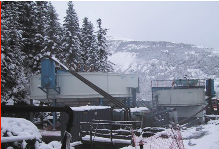
Clarificadores 12 m y 6 m Ø en perforación de túneles
