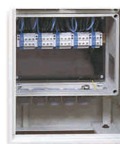
Espacio para conexiones
