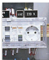
Toma de corriente
