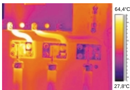
Control de fusibles
