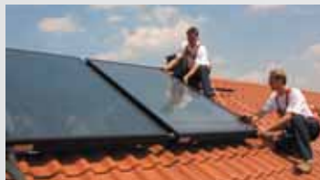
Instalación de energía solar ROTEX Solaris
