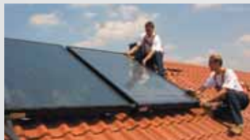
Instalación de energía solar ROTEX Solaris
