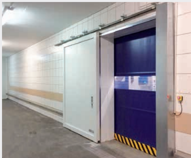
Puerta corredera cortafuegos en industria cárnica.
