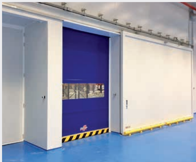
Puerta corredera cortafuegos en laboratorio farmacéutico.
