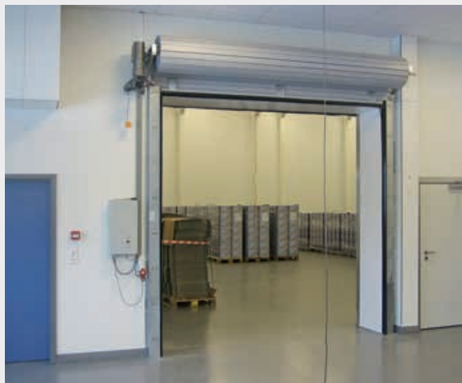
Puerta enrollable cortafuegos EI-Roll Basic® en almacén.
