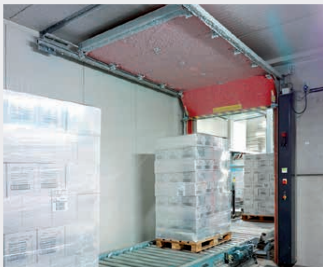
Puerta seccional cortafuegos en cámara de frío.
