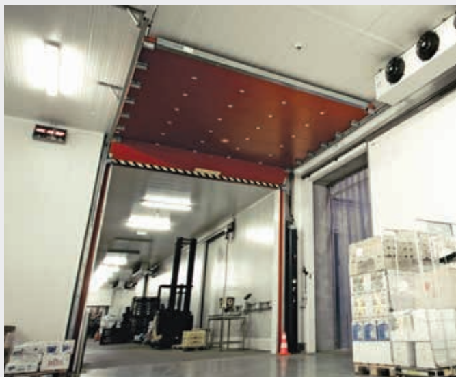
Puerta seccional cortafuegos en almacén de alimentación.
