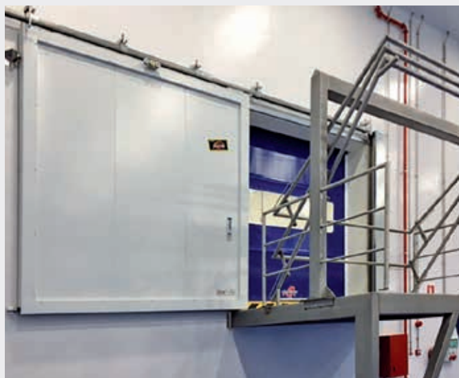
Puerta corredera cortafuegos en industria alimentaria.
