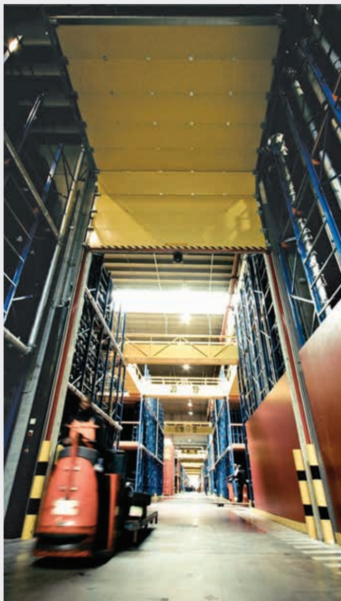
Puerta seccional cortafuegos en compartimentos de almacén.
