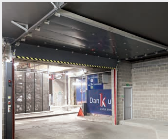
Puerta cortafuegos EI-Secc Hidra® en parking.
