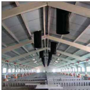
Sistema de Ventilación con Chimeneas
