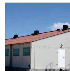
Sistema de Ventilación con Chimeneas
