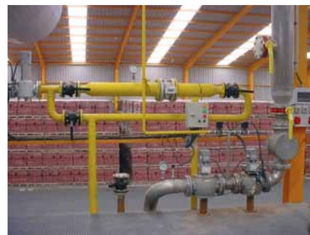
Entrada de canalización del biogás a los hornos de Piera Ecocerámica
