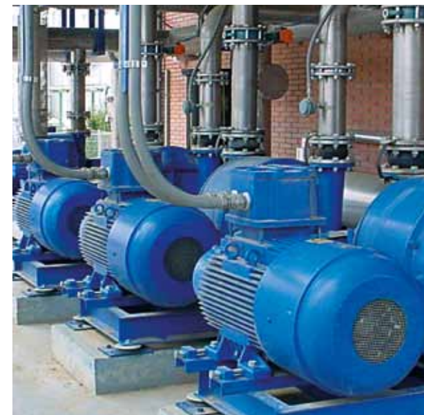
Estación de tratamiento del biogás
