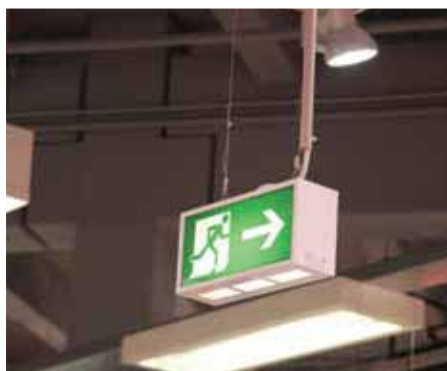
Luminaria de seguridad
