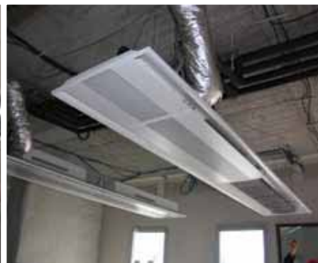
Panel de refrigeración
