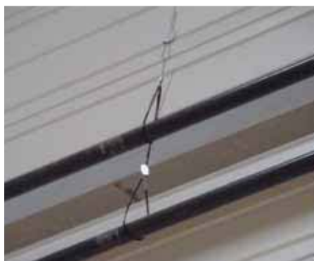
Doble tubería vertical
