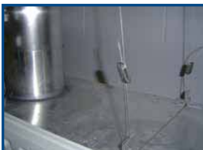
Unidad de aire acondicionado
