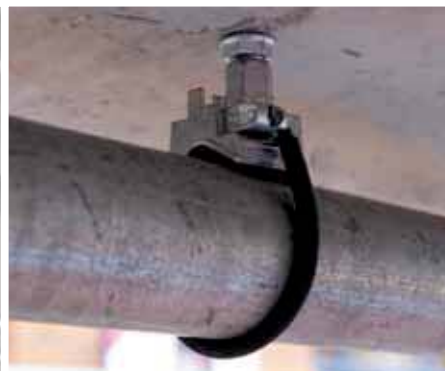
Tubería de acero
