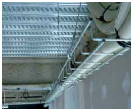
Tubería de refrigeración
