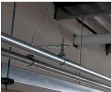
Tubería de calefacción
