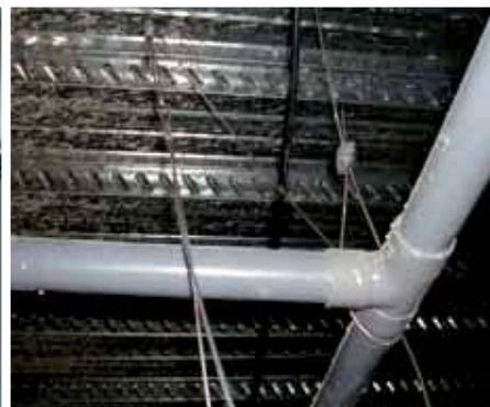
Tubería de condensación de agua
