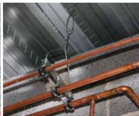
Tubería de cobre
