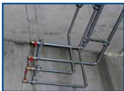
Tubería de acero
