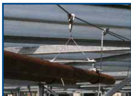
Tubería de acero
