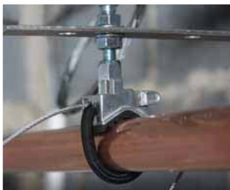
Tubería de cobre
