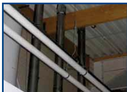
Tubería de acero
