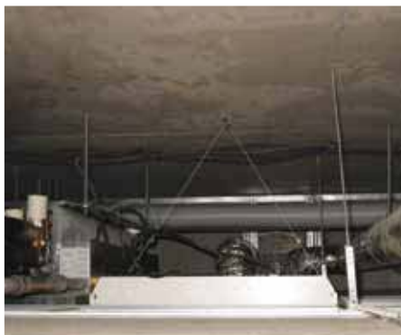
Iluminación de seguridad
