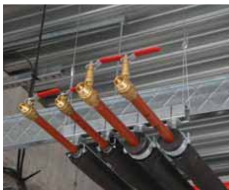
Tubería de acero
