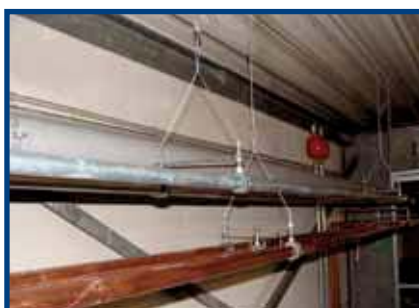
Tuberías de cobre y acero
