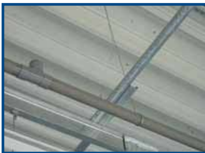
Tuberías de plástico
