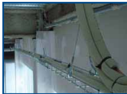
Unidades de refrigeración
