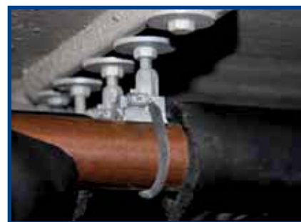
Tubería de cobre
