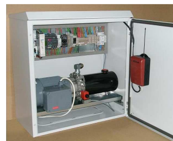
Armario de control
