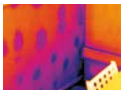
La imagen térmica muestra la presencia de mohos en el interior de una pared debida a la infiltración de agua.
