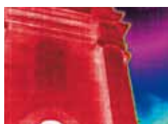
La imagen térmica puede revelar la construcción de una ventana oculta que es invisible a simple vista.
