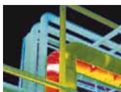
Deterioro de aislantes
