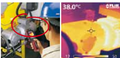
Verificación mecánica de un motor eléctrico con la i60 de FLIR.
