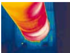
Rotura del refractante en un horno de cemento giratorio
