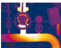
Colector de condensado de vapor
