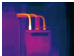
Mala conexión y avería interna
