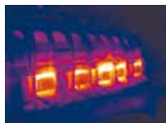
Aislante refractario defectuoso
