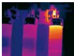
Fusibles internos fundidos
