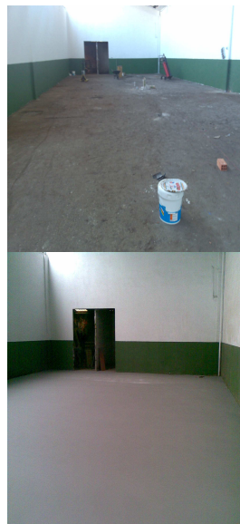
Cemento nivelador en Suelo deteriorado
