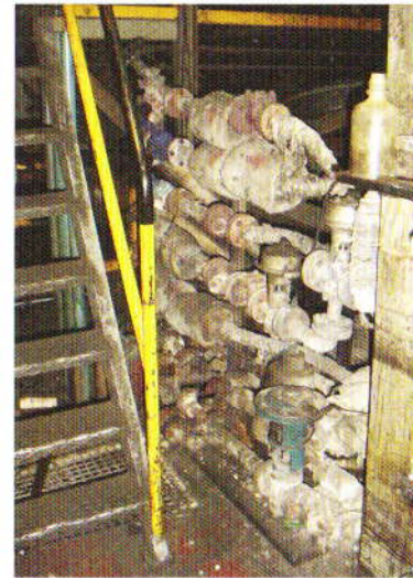
Aislamiento en calderas.
