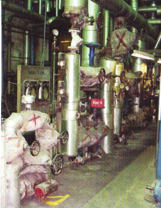
Calderas y tuberías.
