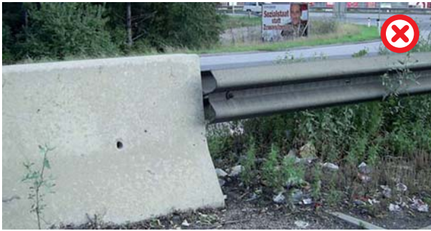
Transición instalada INCORRECTAMENTE.
